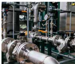
Medición de caudal
