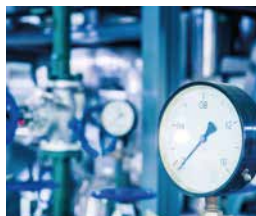
Medición de presión y temperatura
