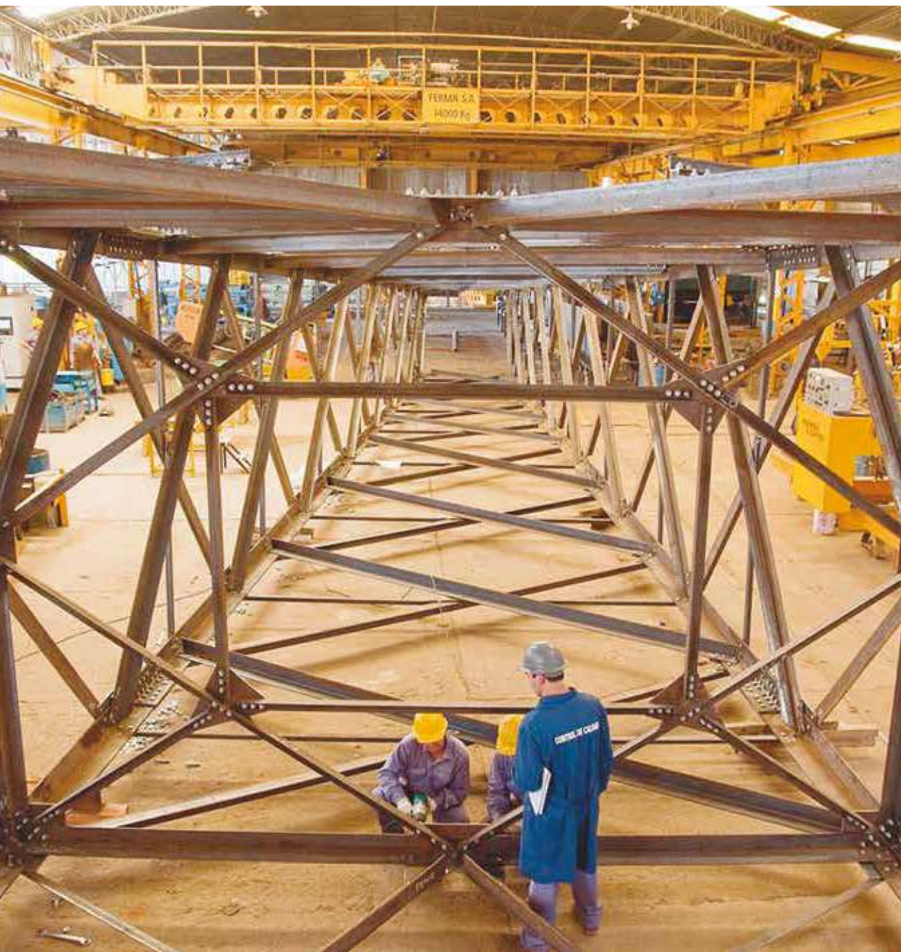
Pórticos de apertura 500 Kv. Arroyo Cabral, Córdoba.
